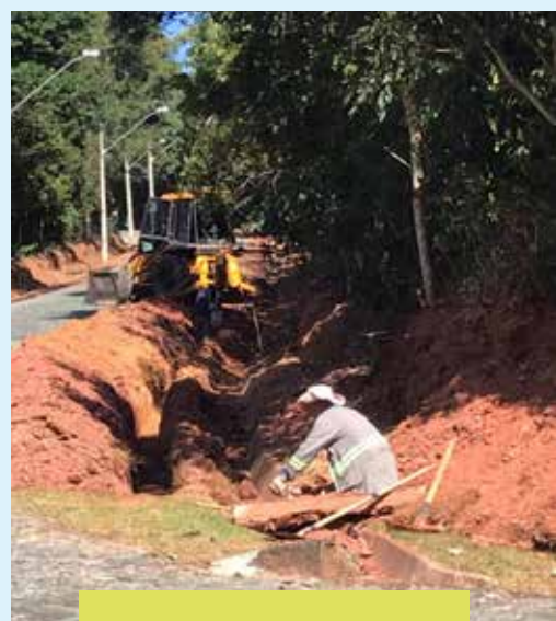
Os funcionários da CONDUTO acompanharam as escavações e orientaram o maquinista na perfuração das valetas
