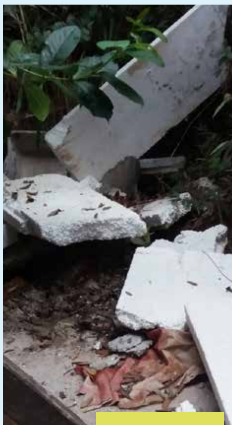
As áreas públicas de passagem de água, algumas tomadas pelas erosões causadas pelas chuvas, estão sendo usadas de forma errada para o descarte de lixo e entulhos de obra
